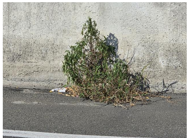
교량 배수구 막힘
